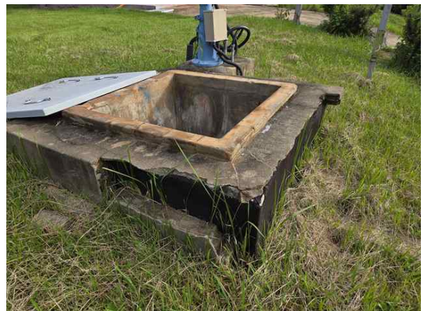
<유출밸브실 2지 입구 파손>
