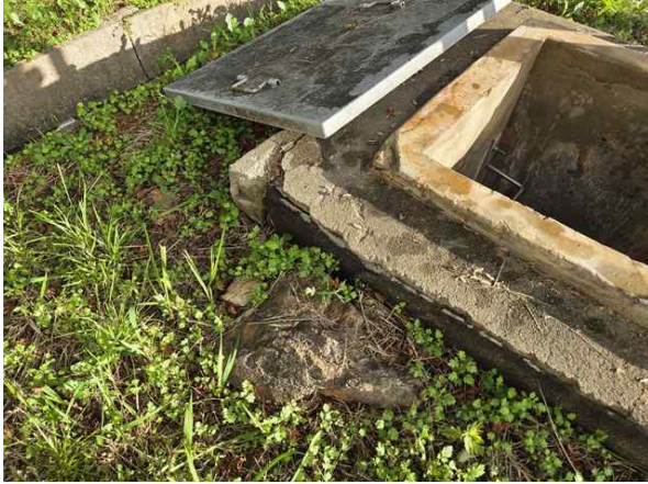
<유입밸브실 2지 입구 파손>
