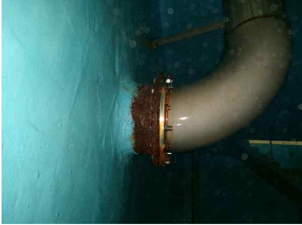
<배수지 1지 유입배관, 볼트류 부식>
