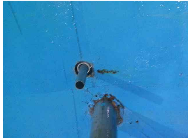
<배수지 1지 상부슬래브 철근노출>
