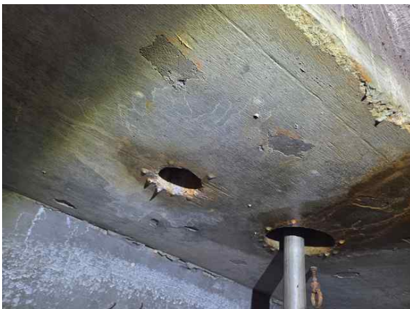
<유입밸브실 1지 상부슬래브 백태>
