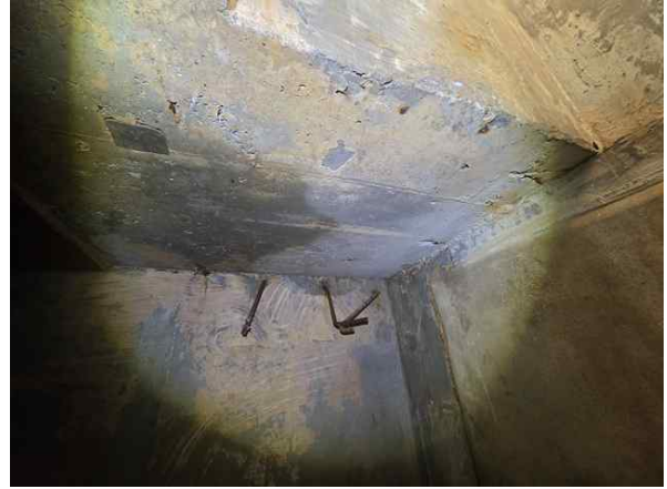
<유입밸브실 2지 상부슬래브 철근노출>
