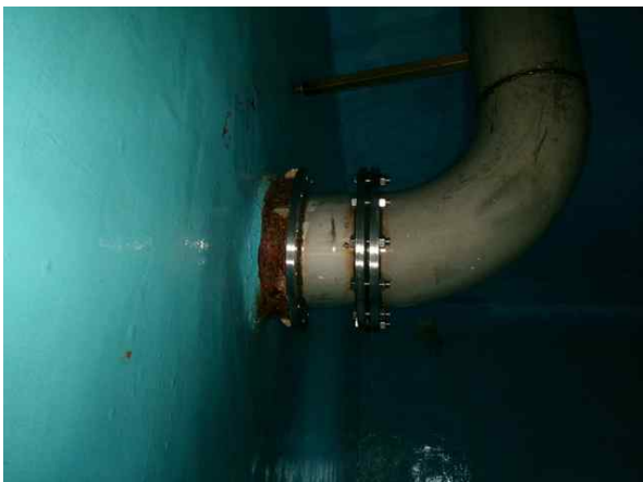
<배수지 2지 유입배관, 볼트류 부식>
