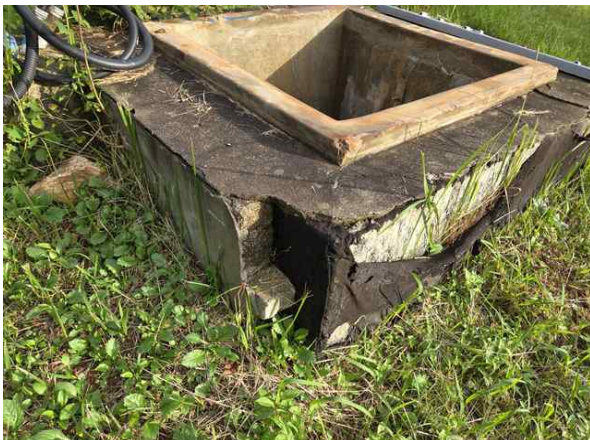
<유출밸브실 1지 입구 파손>
