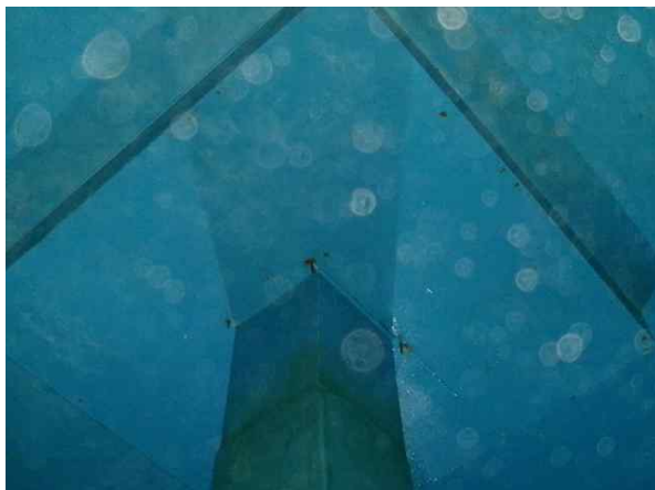
<배수지 1지 상부슬래브 녹>
