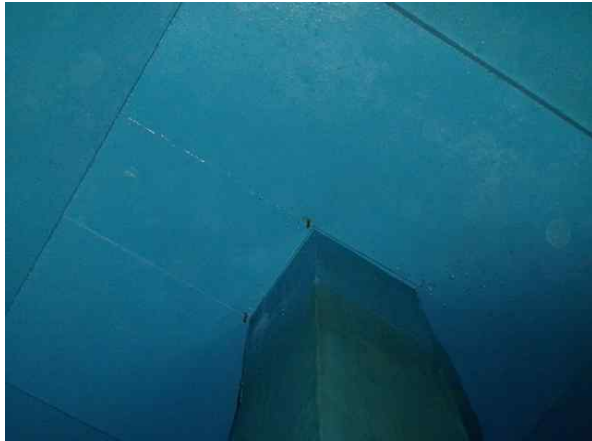
<배수지 1지 상부슬래브 녹>
