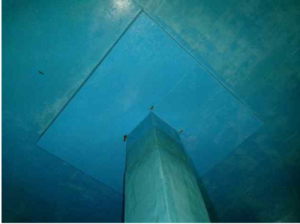
<배수지 2지 상부슬래브 녹>
