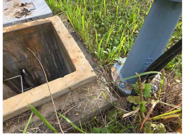
<유입밸브실 1지 입구 파손>
