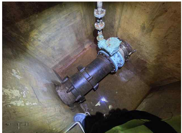
<유입밸브실 2지 배관, 볼트류 부식>
