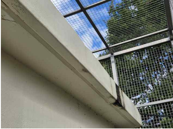
<계단실 외부 상부슬래브 파손>
