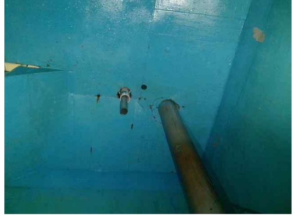
<배수지 2지 상부슬래브 박락>
