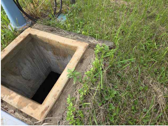
<유입밸브실 1지 입구 파손>
