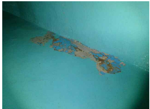
<배수지 2지 하부슬래브 도장박리>
